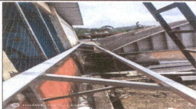
Foto7: Techo detrás de direccion
