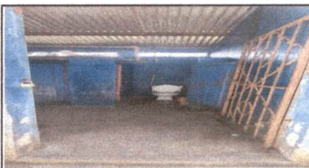
Foto 6: Puertas de baños
